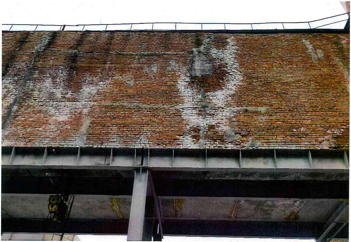
Рис.4. Газоход от паровых котлов
