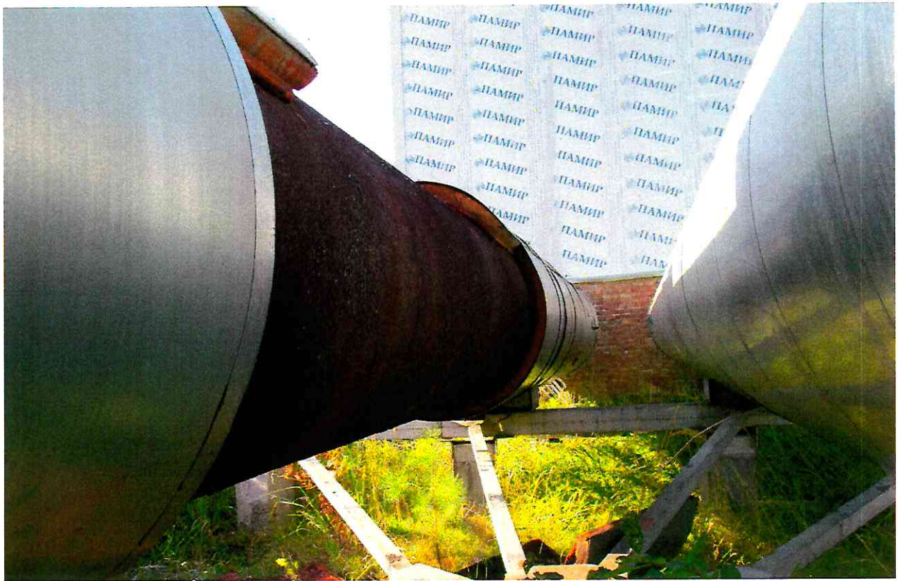
Рис.9 Участок тепловых сетей
