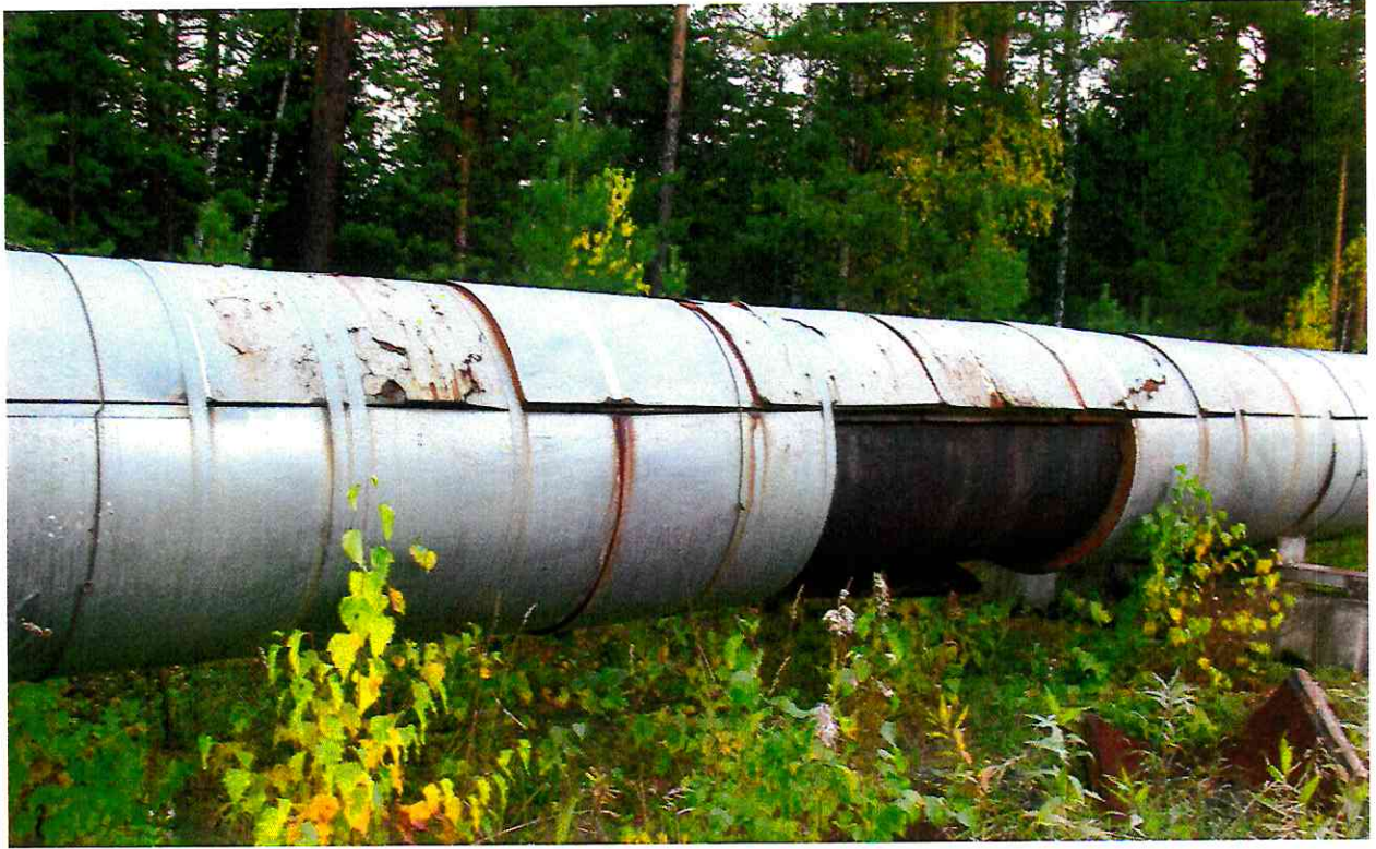
Рис.8 Участок тепловых сетей
